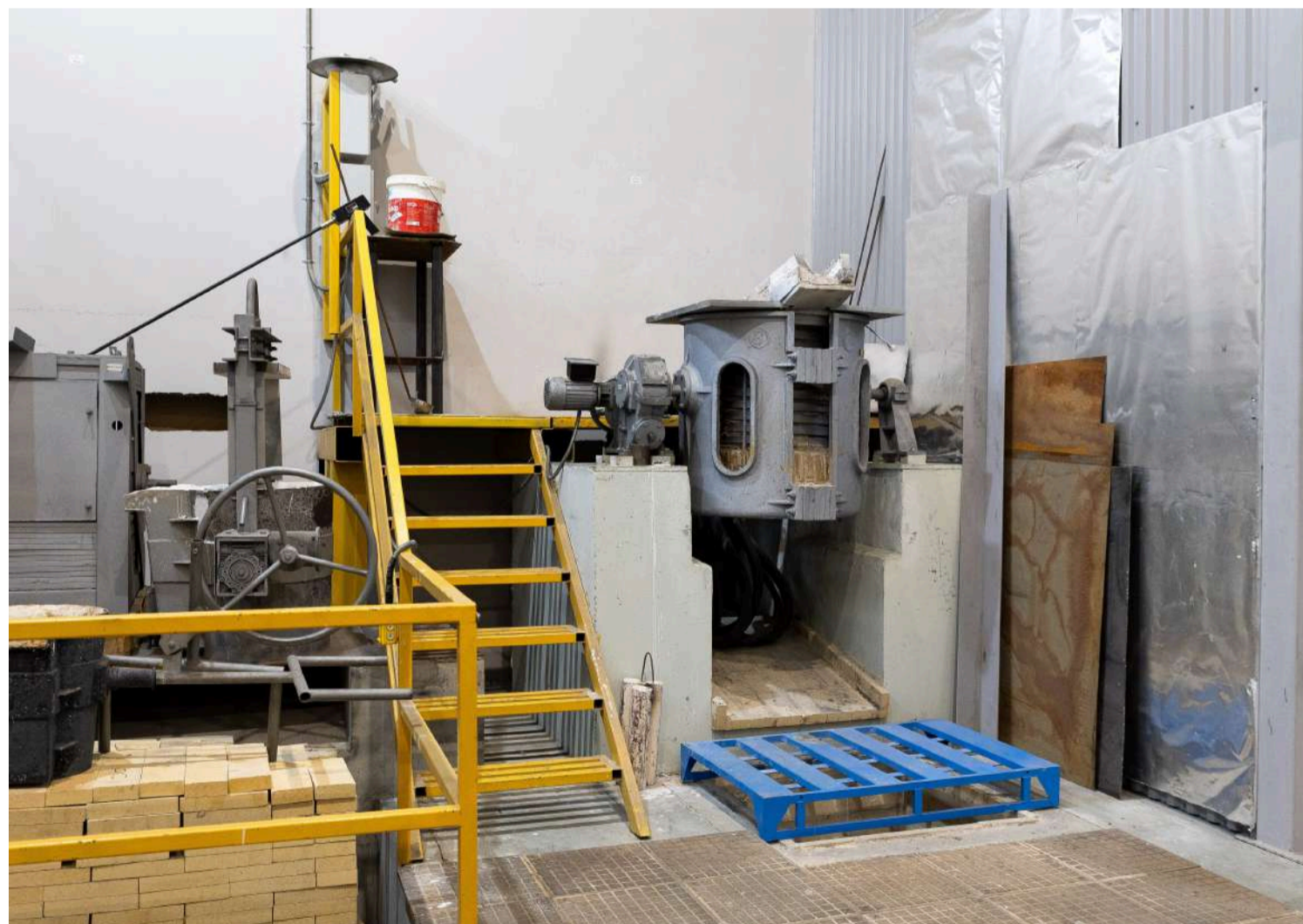
Сталеплавильный тигельный комплекс с двумя плавильными постами
